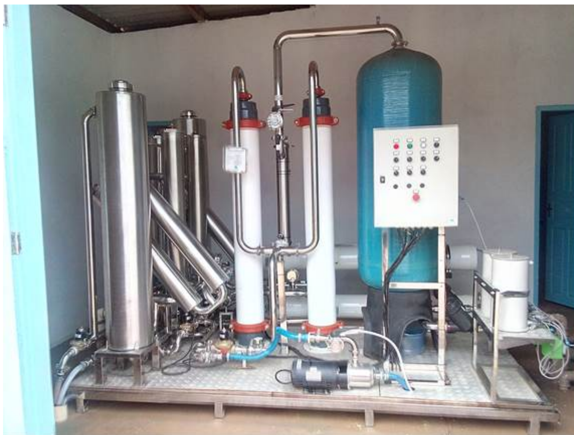
Figura 2: ETA compacta Limoeiro – Castelo/ES
